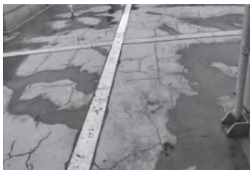
细石混凝土屋面开裂图
